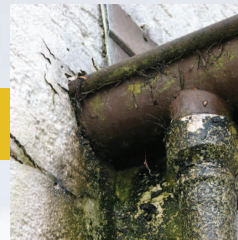
Defekte Dachrinnen zerstören oft auch die Haussubstanz
